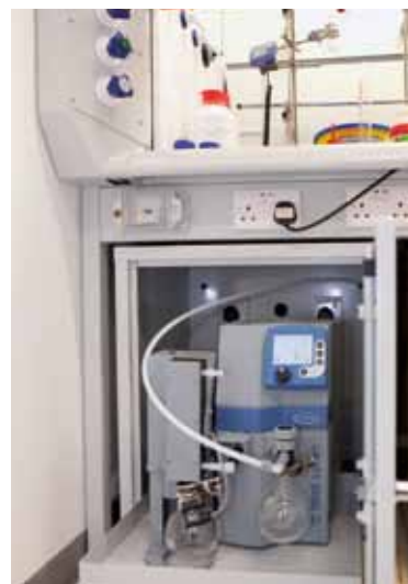
Estación de bombeo de red versión química debajo de la campana de gases, con recuperación de disolventes
