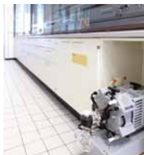
Zona o área de laboratorio protegida con equipo ATEX
