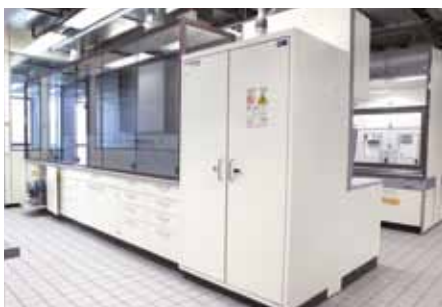
Suministro de vacío en un área de trabajo con campana de seguridad
